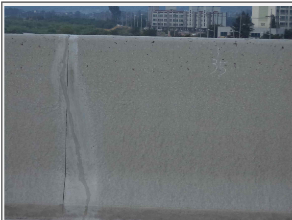
내 용 방호시설 균열보수
