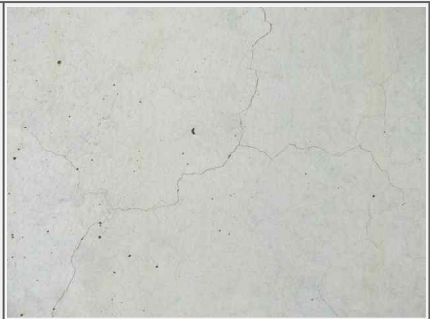
내 용 영천 P9 망상균열
