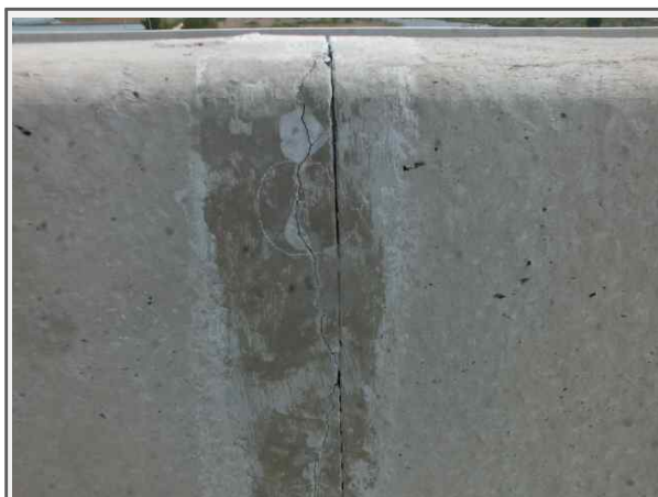
내 용 방호벽 조인트부 파손(영천-S2)
