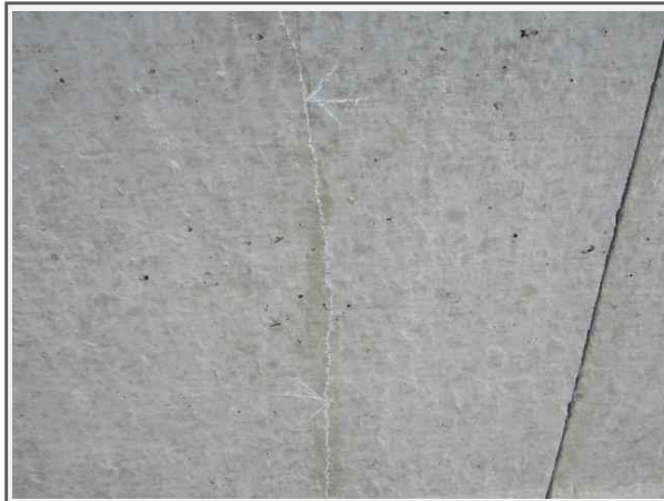
내 용 방호벽 균열(상주-S4)
