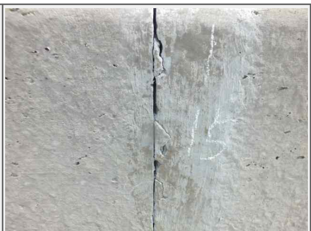
내 용 방호벽 조인트부 파손(영천-S6)
