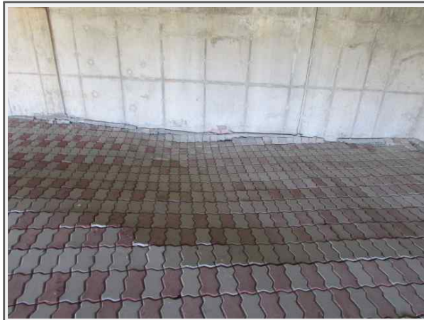
내 용 상주 A1 사면 보호블럭 침하
