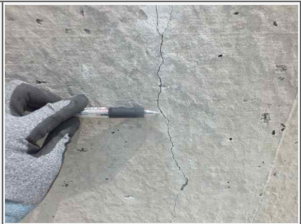
내 용 방호벽 균열(영천-S7)
