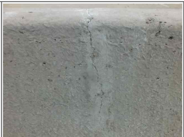
내 용 방호벽 보수부 재균열(영천-P4)
