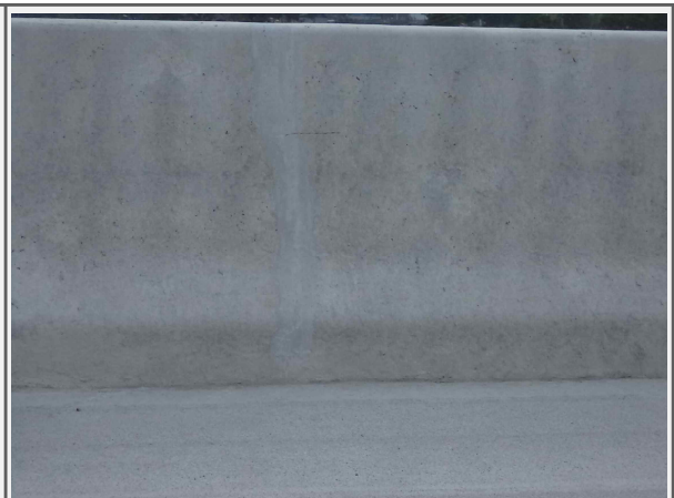
내 용 방호시설 균열보수
