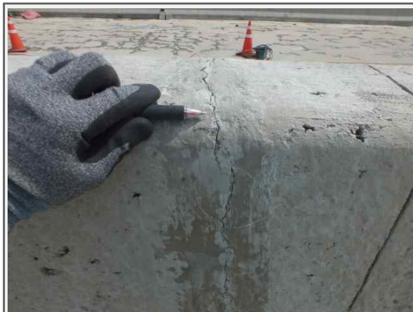
내 용 방호벽 보수부 재균열(영천-S1)
