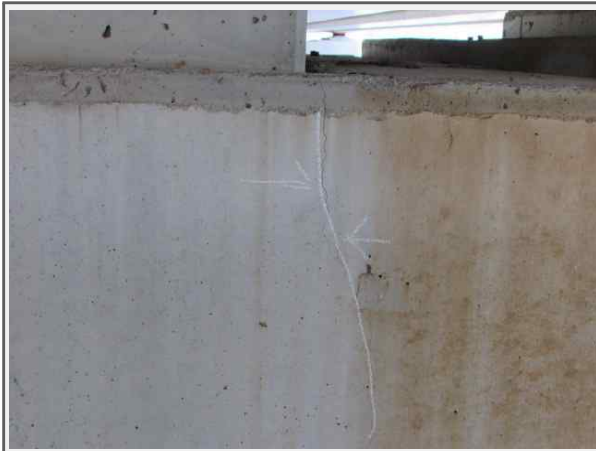
내 용 영천 P1 균열 (cw=0.3mm)
